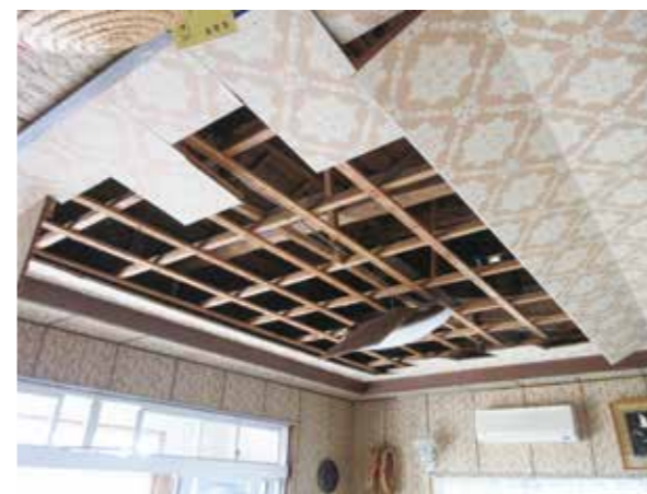
崩落した2階の天井
